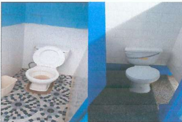
Foto 4: SERVICIOS SANITARIOS Y SUS ACCESORIOS
